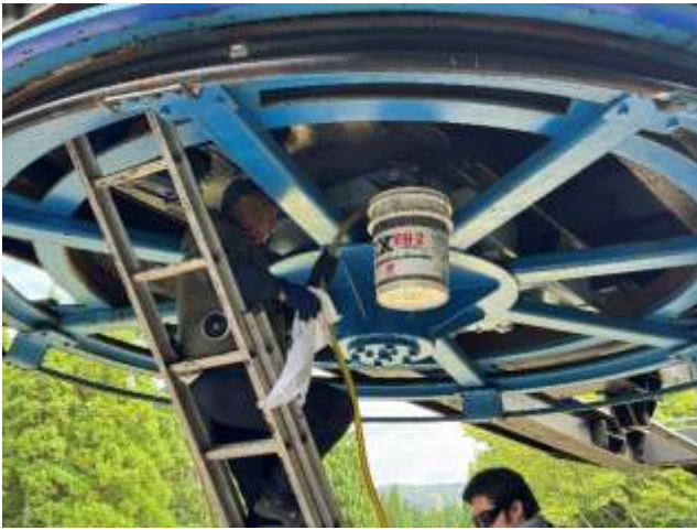
第1ロマンスリフト 減速機オイル交換
